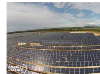
Centrale de Belvezet, Gard
